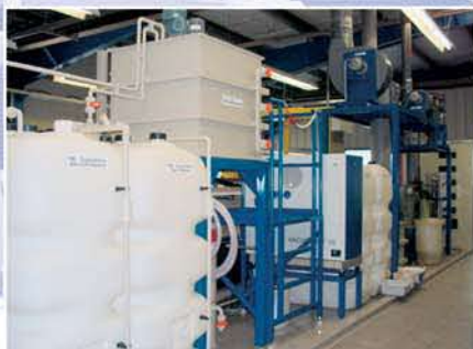
Abwasserbehandlungs- und Abluftanlagen
