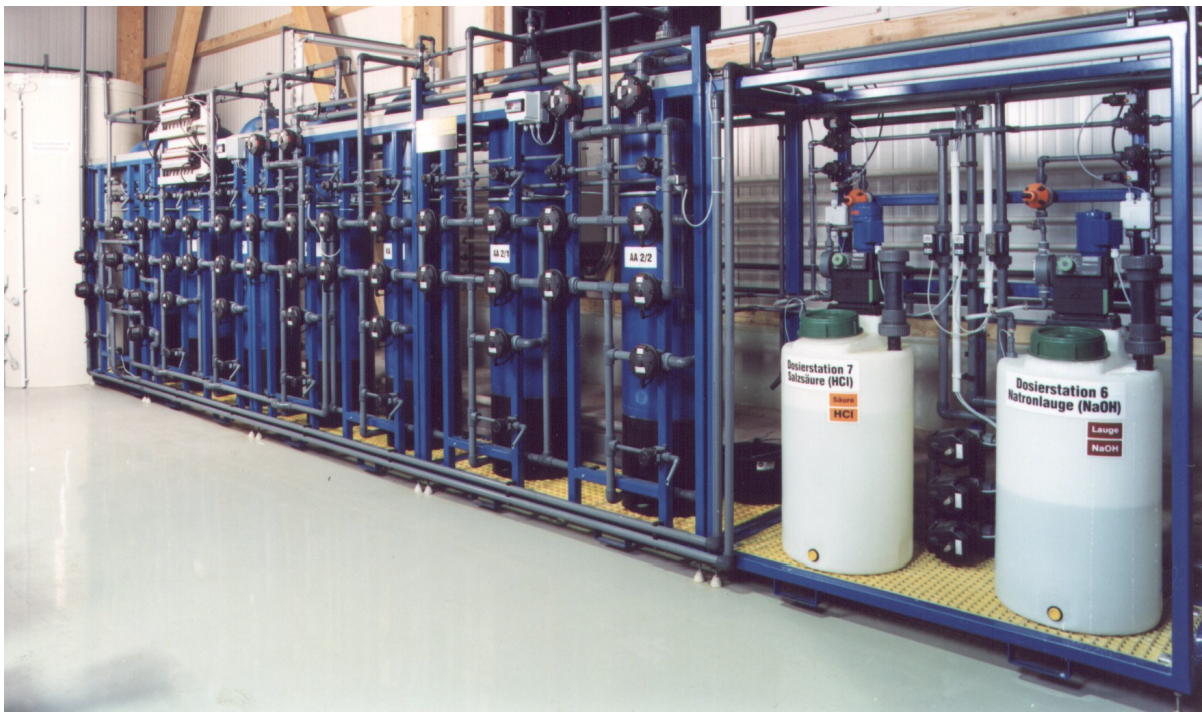
Bild: Zweistraßige automatische Ionen-Austauscher-Kreislauf-Anlage mit Regenerierstation
